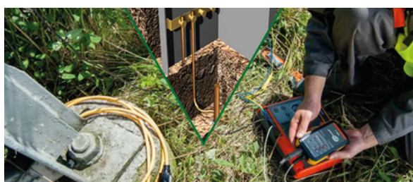
MANTENIMIENTO DE POZOS A TIERRA
