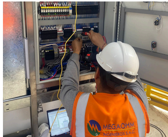
DISEÑO Y FABRICACIÓN DE TABLEROS ELÉCTRICOS DE FUERZA Y CONTROL
