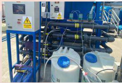
PLANTA DE TRATAMIENTO DE AGUA PTAR
