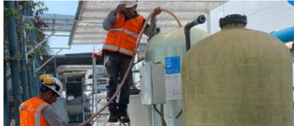
SISTEMA DE ABLANDAMIENTO
