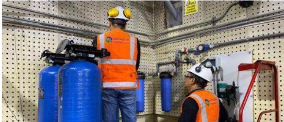
PLANTA DE TRATAMIENTO DE AGUA POTABLE
