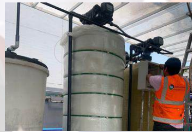
SISTEMAS DE ABLANDAMIENTO, DOSIFICACIÓN QUÍMICA Y BOMBEO
