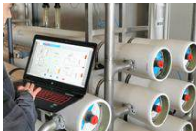
PLANTAS DE TRATAMIENTO MEDIANTE NANOFILTRACIÓN (RO/NF), MICROFILTRACIÓN (MF).
