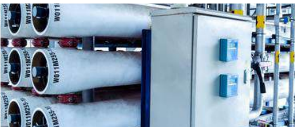
SISTEMA DE ULTRAFILTRACIÓN
