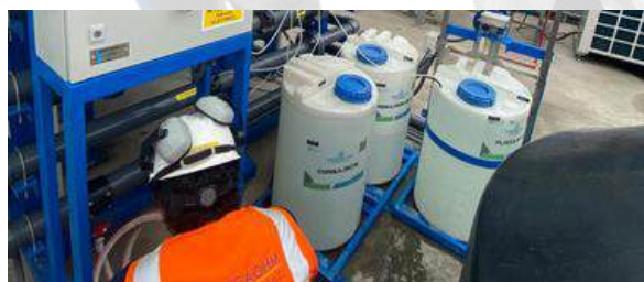
SISTEMA DE CLORACIÓN Y PH
