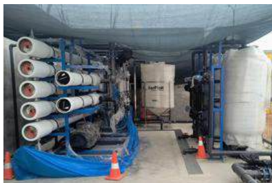
PLANTAS DE TRATAMIENTO MEDIANTE ÓSMOSIS INVERSA
