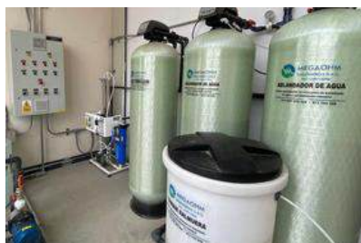
PLANTAS DE AGUA POTABLE
