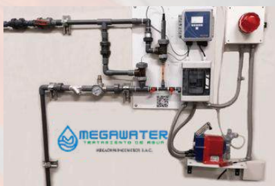
SISTEMA DE CLORACIÓN AUTOMATIZADA
