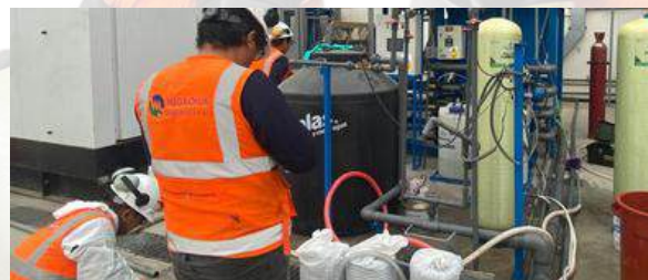
PLANTA DE TRATAMIENTO DE AGUA RESIDUAL-PTARI
